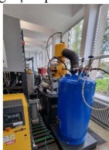
Instalație azot lichefiat
